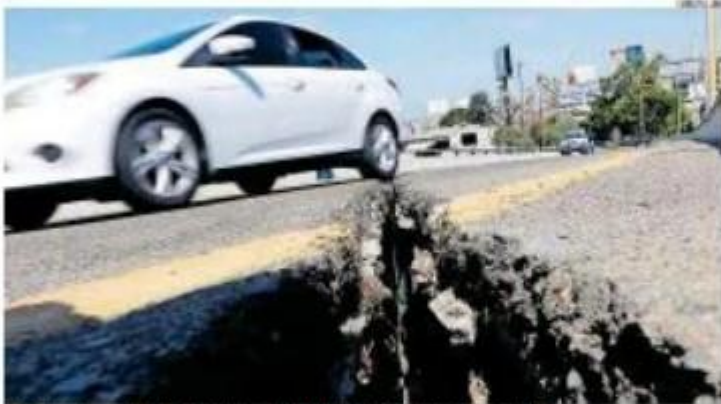
López Torres mencionó que a 11 años de su construcción el puente se ha hundido poco más de 50 centímetros.
